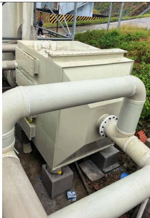
污水处理站活性炭吸附
