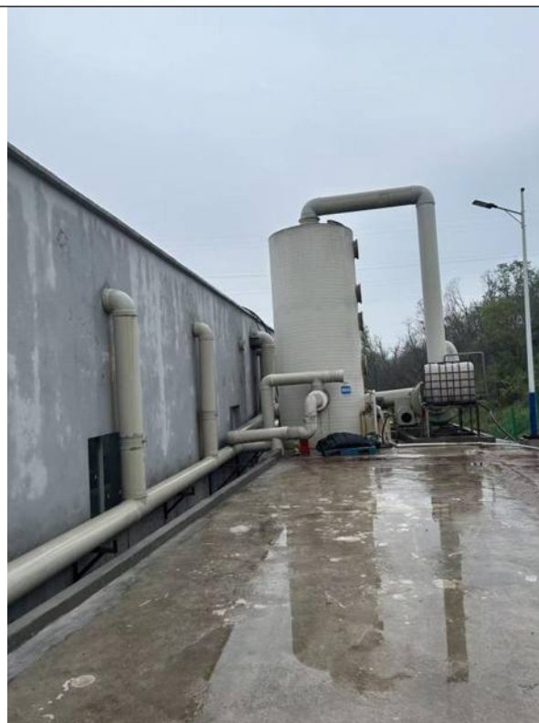
危废暂存间废气处理设施
